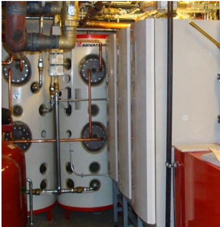
Suomen Uusiutuva Energia Oy:n maalämpölaitteisto Hinthaaran koululla.
